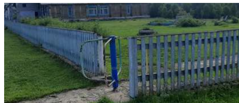
Неудовлетворительное состояние ограждения у ДК
