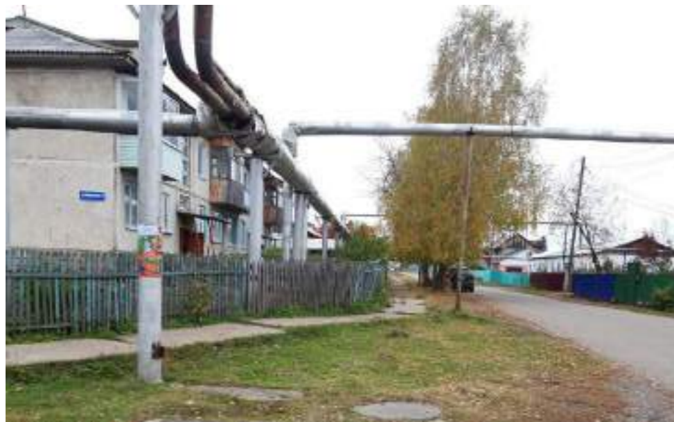
Наземное расположение теплотрассы
